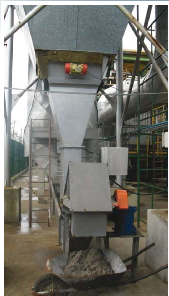
Detalhe do equipamento de filtragem de cinzas, Usina Verde S/A Parte del filtro de Usina Verde S/A
