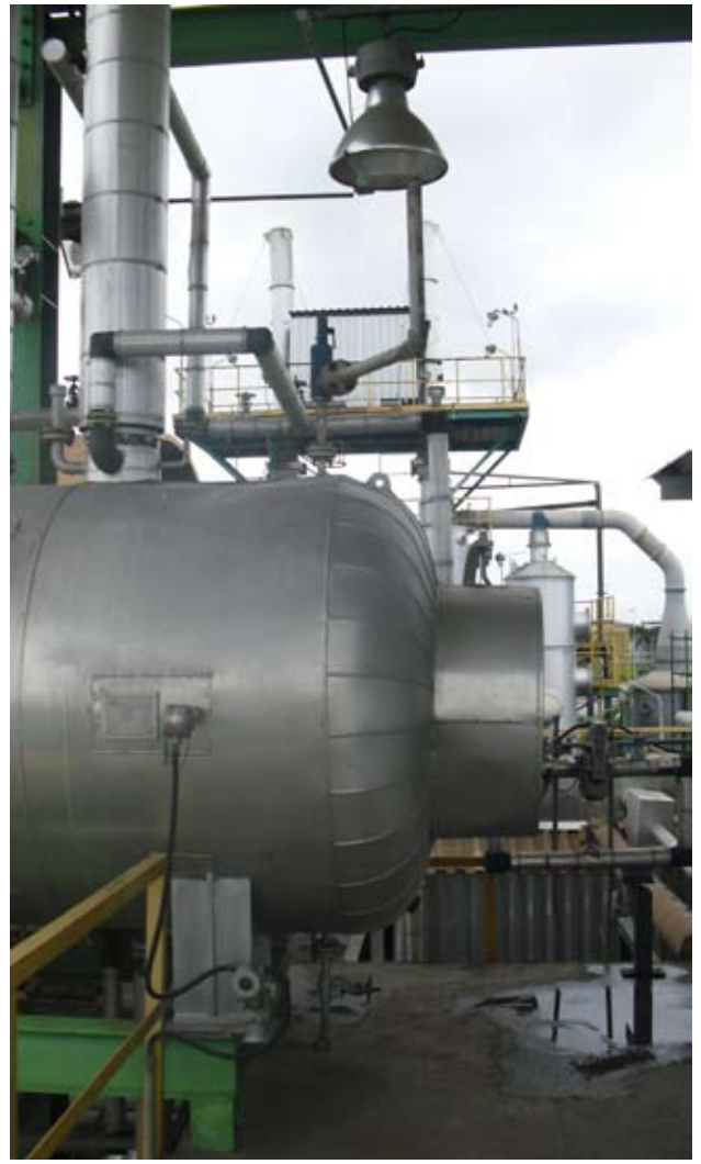
Detalhe do forno de queima da Usina Verde Detalle del horno de Usina Verde
