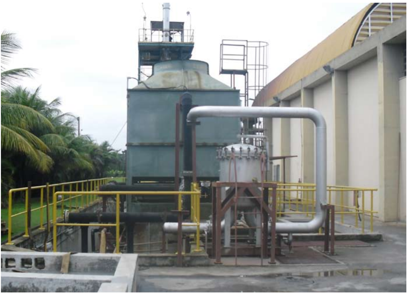
Vista geral dos equipamentos externos da Usina Verde Vista general de las instalaciones externas de Usina Verde
